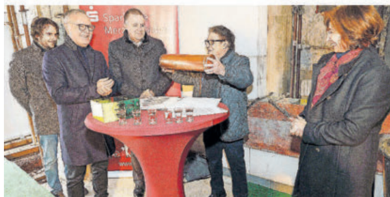
Grundsteinlegung zum neuen Sparkassenhaus in der Merziger Schankstraße am 18. Dezember mit (von rechts): Landrätin Daniela Schlegel-Friedrich, Kurt Kühnen, Wolfgang Fritz, Frank Jakobs und Karsten Kühnen. FOTO: MANFRED MÜLLER
