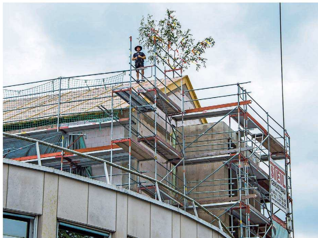
Richtfest am Freitag bei der Sparkasse Merzig-Wadern: Polier Michael Schramm bei dem traditionellen Richtspruch in luftiger Höhe.
