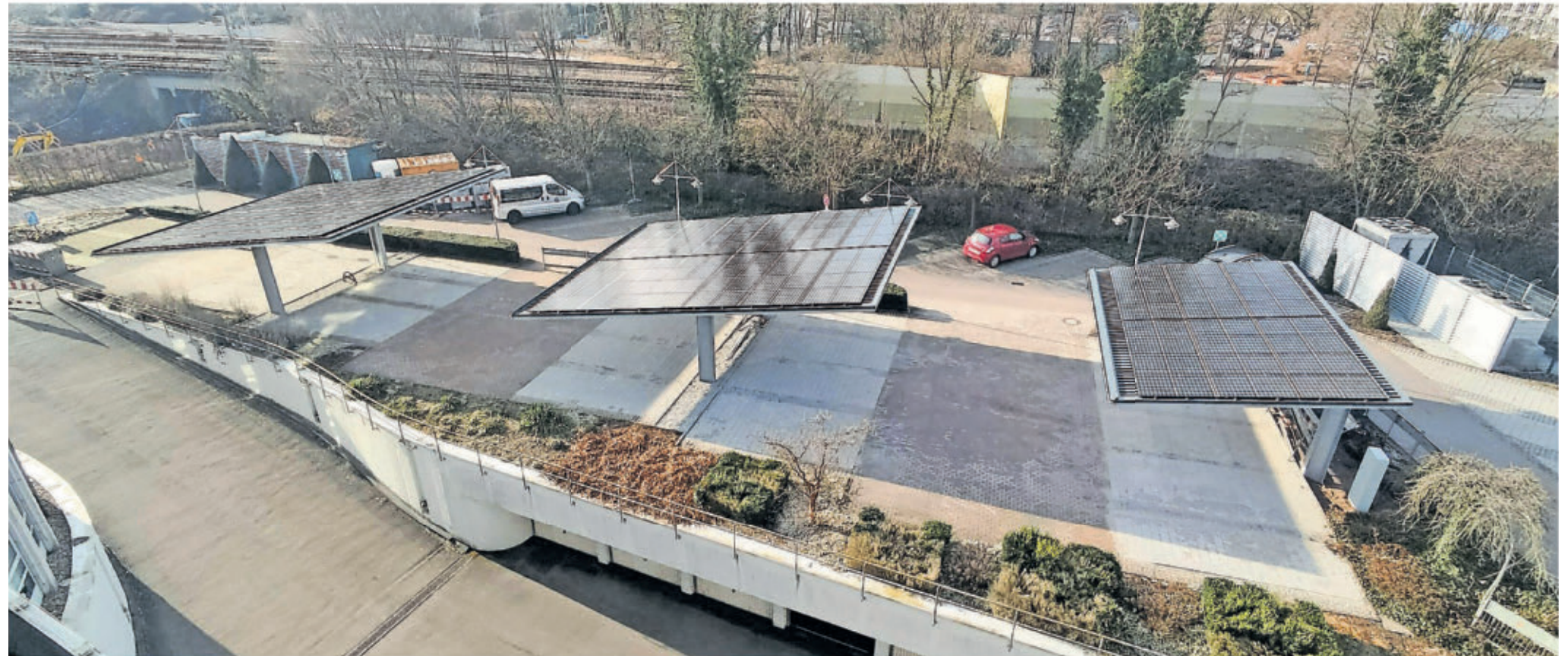
Die drei neuen Carports auf dem Kundenparkplatz der Sparkasse Merzig-Wadern bieten Platz für 120 PV-Module.
